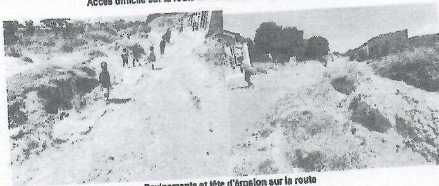
Accès difficile sur la route dû au manque de passage sous route
