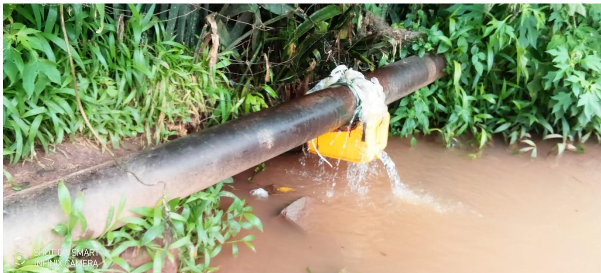
Figure 1: conduite de la Gécamines Kolwezi
